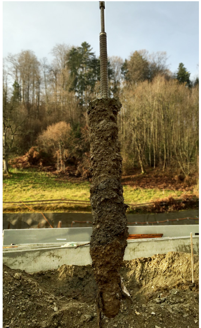
Herausgezogenes komplett mit KUMIX ummanteltes KÜPS ®-System
