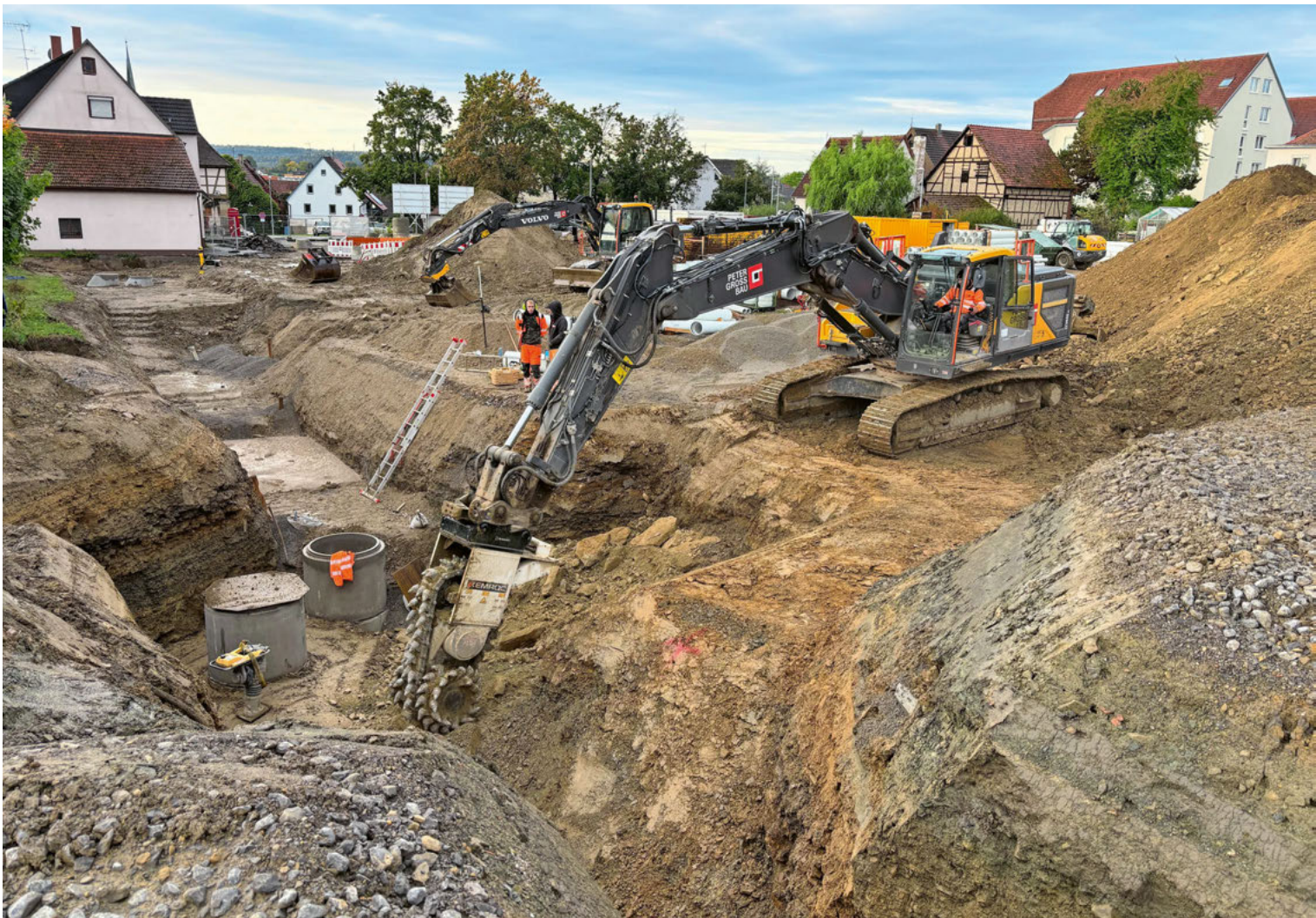
Der 35-t-Bagger aus dem Maschinenbestand des Bauunternehmens wurde mit einer angemieteten Kemroc-Kettenfräse EK 150 ausgerüstet.
