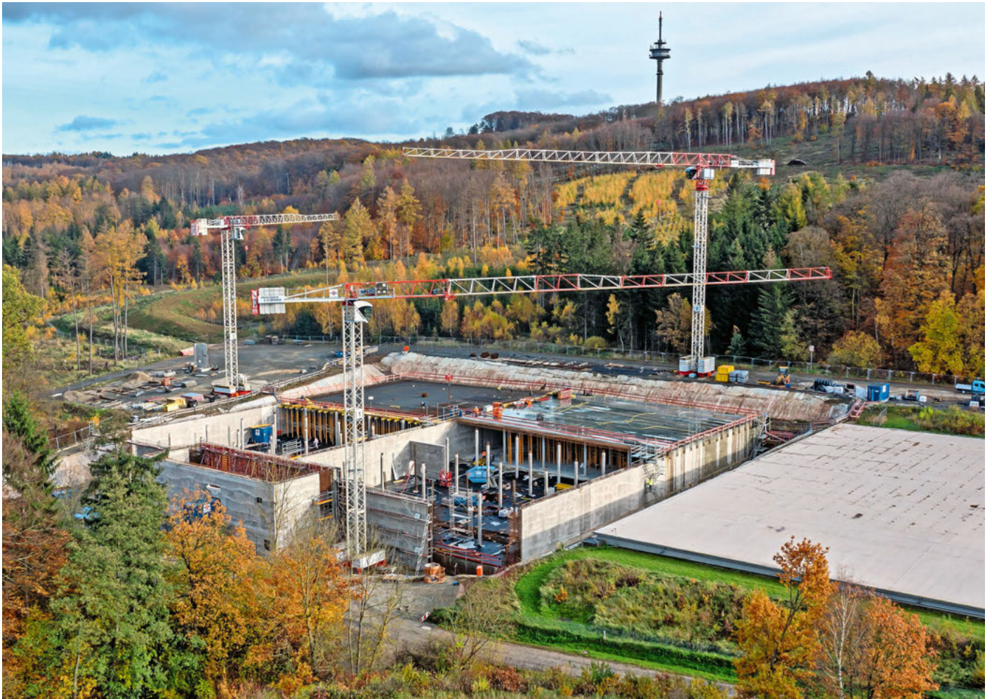
Der neue Hochbehälter weist ein enormes Fassungsvermögen von insgesamt 25'000 m 3 auf.
