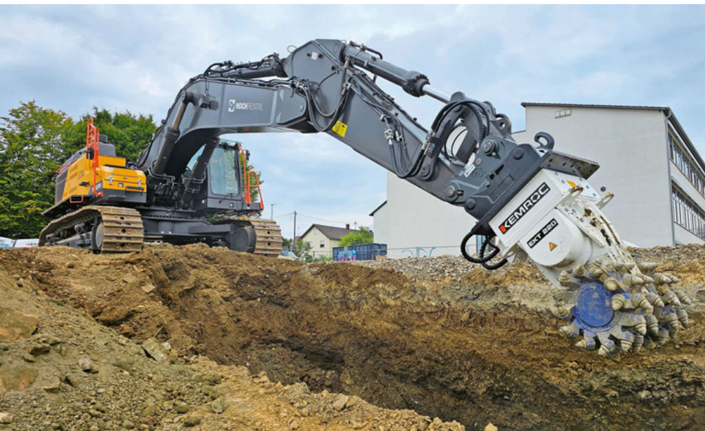
Der 75-Tonner wurde in Absprache mit dem Kemroc-Berater mit einer Querschneidkopfräse EKT 220 bestückt.
