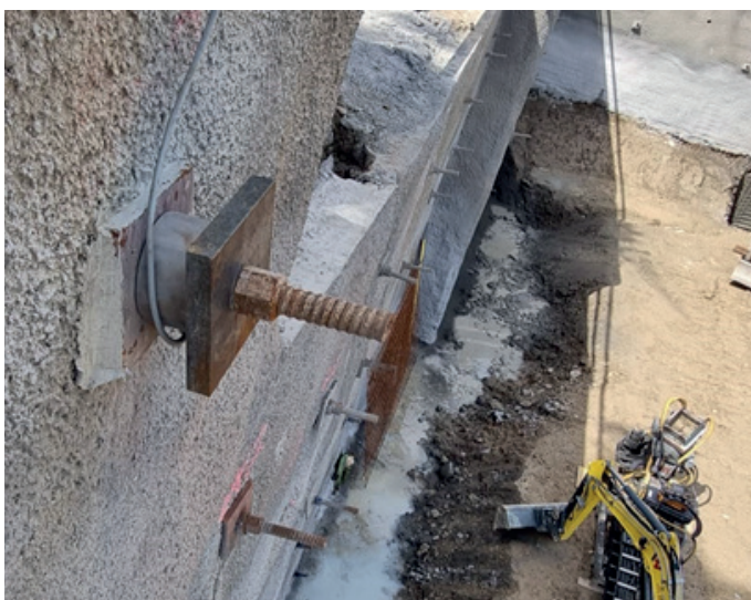
Nach SIA 267 geprüft und abgespannt. Mit eingebauter Kuechler-Kraftmessdose und mit Loggersystem dauerüberwacht.
