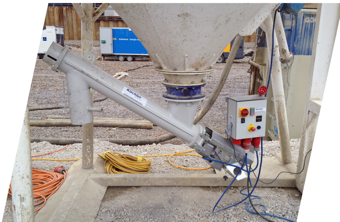
Pour le remplissage automatique de l'installation d'injection
