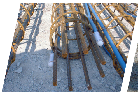
Fixation des conduites d'injection sous pression K
