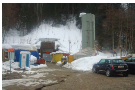
Installation inkl. Silo
