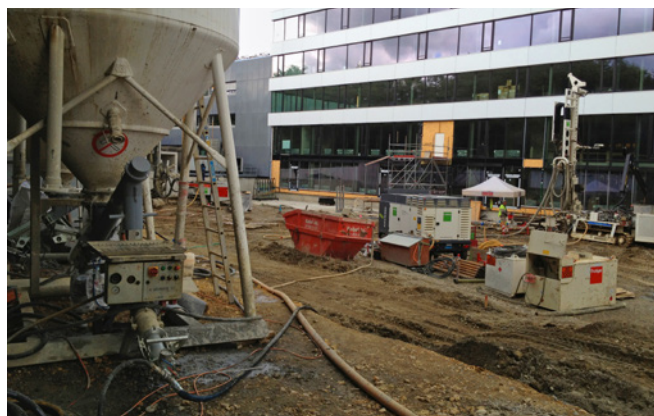
Automatisierte Silo- und Pumpentechnik
