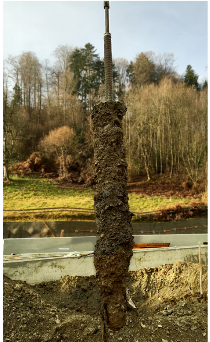
Herausgezogenes komplett mit KUMIX ummanteltes KÜPS ®-System
