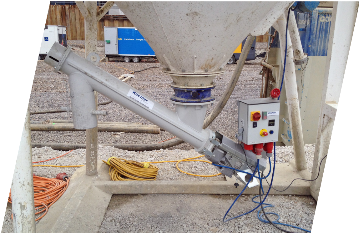
Zur automatischen Befüllung der Injektionsanlage
