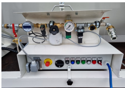
Steuerschrank und Wassersystem
