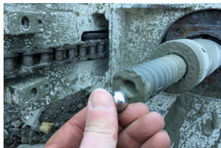
5. Erreichen der Verankerungslänge. Abkoppeln am Bohrhammer, Dämpfungsschlagadapter entfernen, Abpressadapter montieren, Kugel in die KSB® Ankerstange einführen und mittels KÜMIX® den inneren Ringraum über das Injektionsventil bei der Bohrkronen injizieren. Beim Austritt des Abpressadapters wird der Ausgang mittels Kugelhahnen geschlossen und der innere Ringraum, mit 2 Bar, auf Dichtigkeit überprüft.
